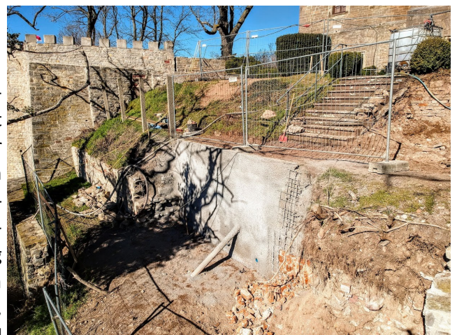
Die Hangsicherung der Baustelle, damit während der Arbeiten nichts nachrutscht. Die eigentliche Stahlbetonstützmauer wird davor gesetzt.
